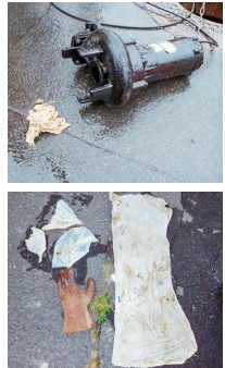
マンホールポンプに詰まっていた異物
