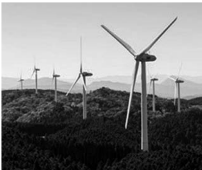
山頂の風力発電設備（設置例）
