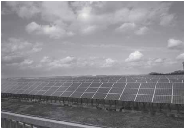
三国太陽光発電所
