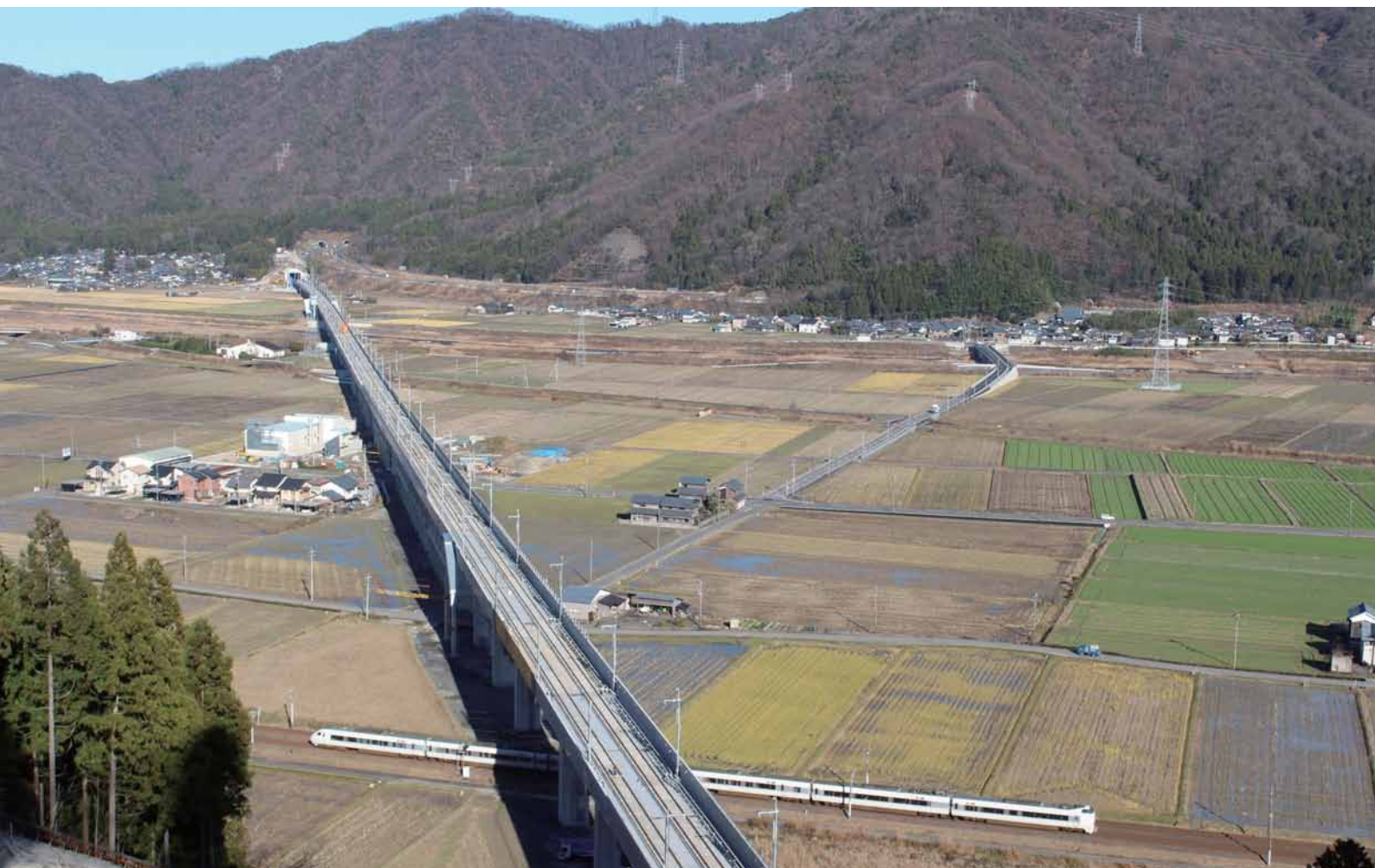
建設中の北陸新幹線、在来の北陸線、北陸自動車道と11月完成の上平吹橋など
