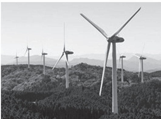
山頂に設置された風力発電設備
