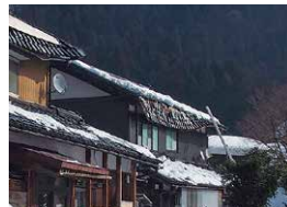
屋根雪による被害
